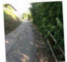
Der Windflachberg löst sich auf, doch die Sanierung wurde aufgeschoben ...
